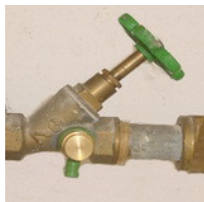
Wohnungsabspernung: Kann auch eine verchromte Unterputzarmatur sein!
