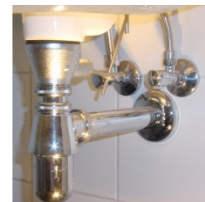
Eckventile unter dem Waschbecken mit Sifon
